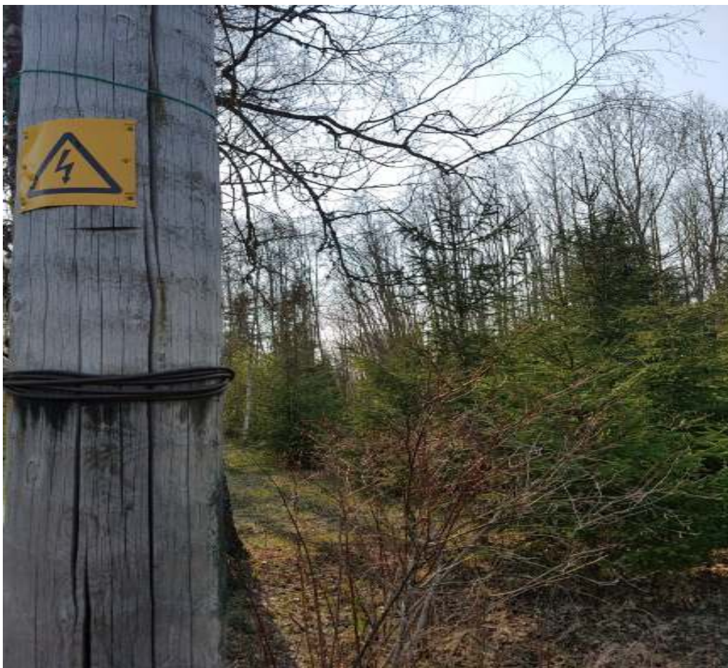
Vaade õhuliini masti kohalt, kuhu on planeeritud elektrienergia liitumiskilp
